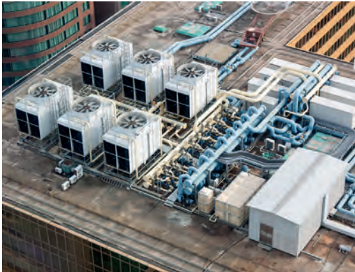
Climatisation et ventilation (HVAC)
