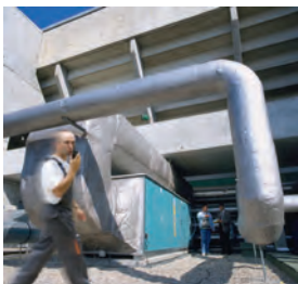
Centrale de traitement d'air
