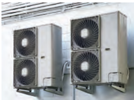
Pompe à chaleur
