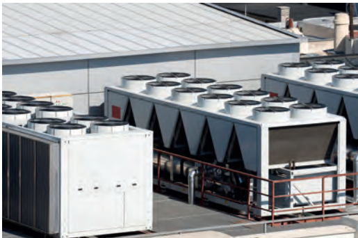
Groupe de production d'eau glacée
